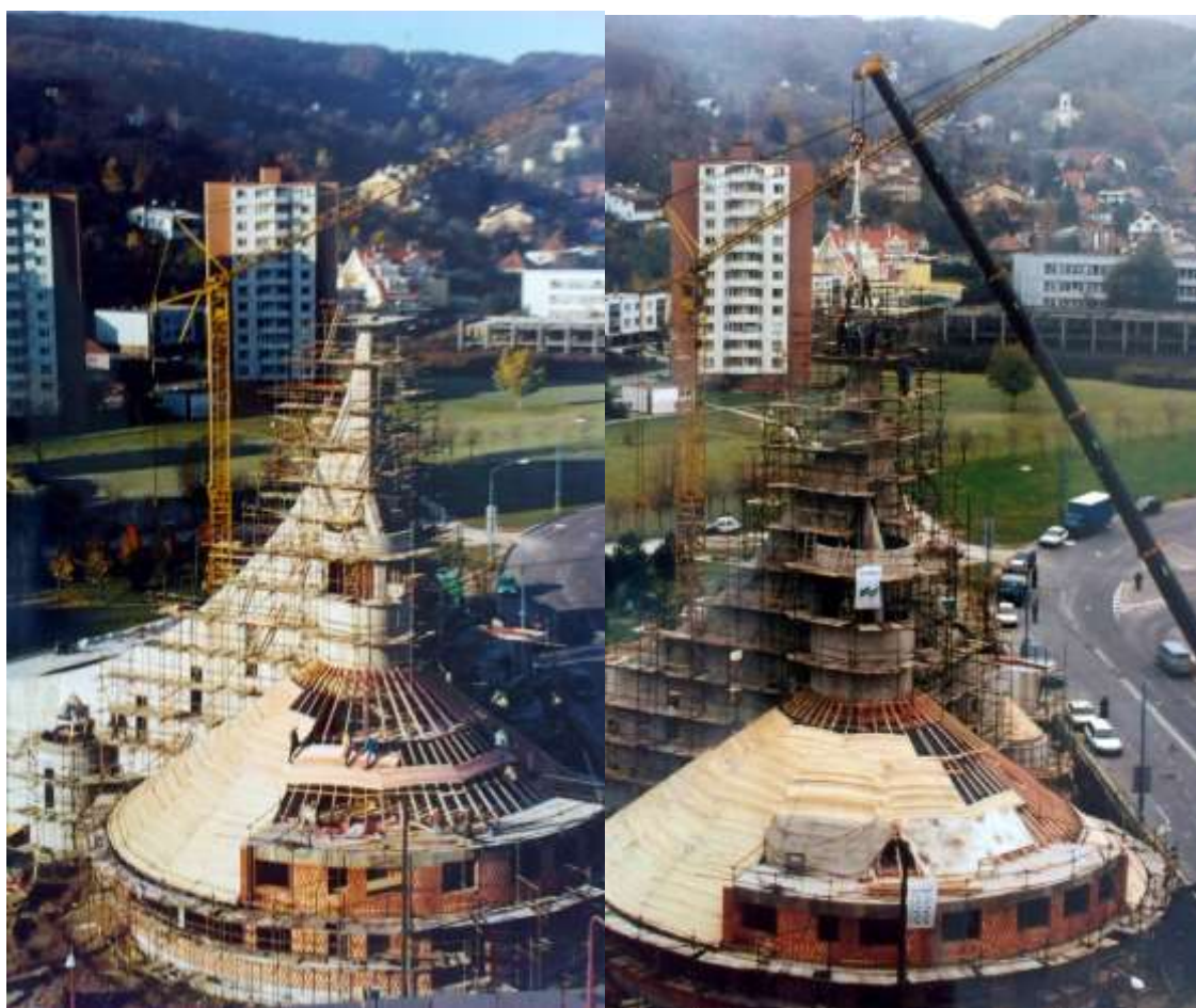
Postupný rast budovy nového kostola, 2000-2001. Transport posväteného kríža na vežu kostola 26.11.2001. V pozadí na kopci je vidno farský kostol – pod jeho „dohľadom“ stavba prebiehala.
